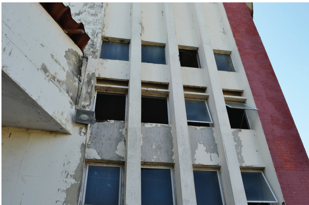
Durante a greve, professores se mobilizaram por melhores condições de trabalho e construíram pauta local de reivindicação. Acima, foto do PQ' - prédio em péssima condição de conservação.
