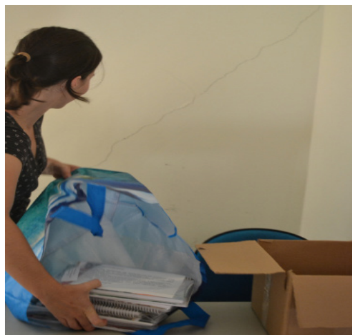
Sala dos professores está com rachaduras no IM
